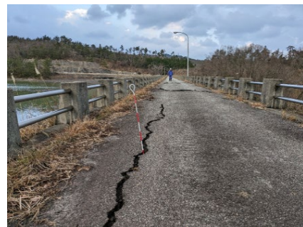
写真3: ダム堤体のひび割れ(寺家ダム)
