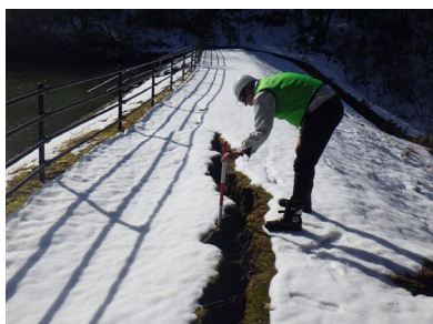
写真8：ため池堤体のひび割れの調査
