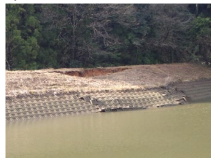
写真4: ため池堤体の崩落
