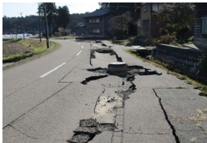
写真7：集排マンホールの隆起
